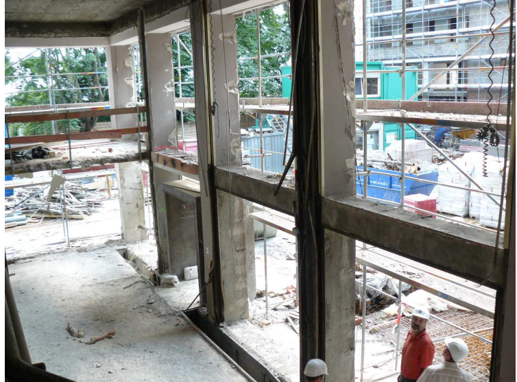
Bild 7: Rohbausituation unmittelbar nach den Abbruchmaßnahmen. Das vorhandene Tragwerk wurde teilweise ertüchtigt und weiter erwendet. Bei einer Kernsanierung ist qualifizierte Planung besonders wichtig, damit die Termin und Kostenziele eingehalten werden können
